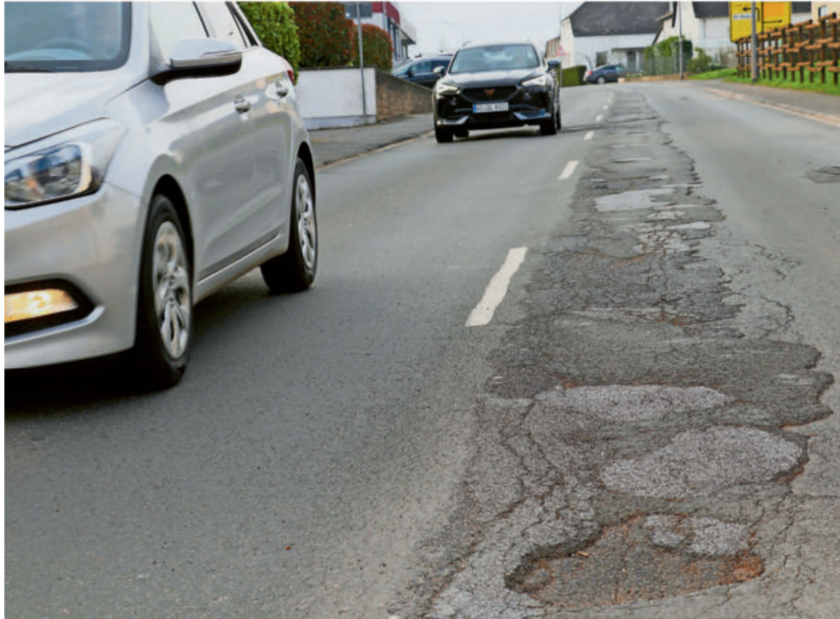
An vielen Stellen ist die Ortsdurchfahrt in Bombogen in einem sehr schlechten Zustand, wie man hier in der Raiffeisenstraße erkennen kann.
