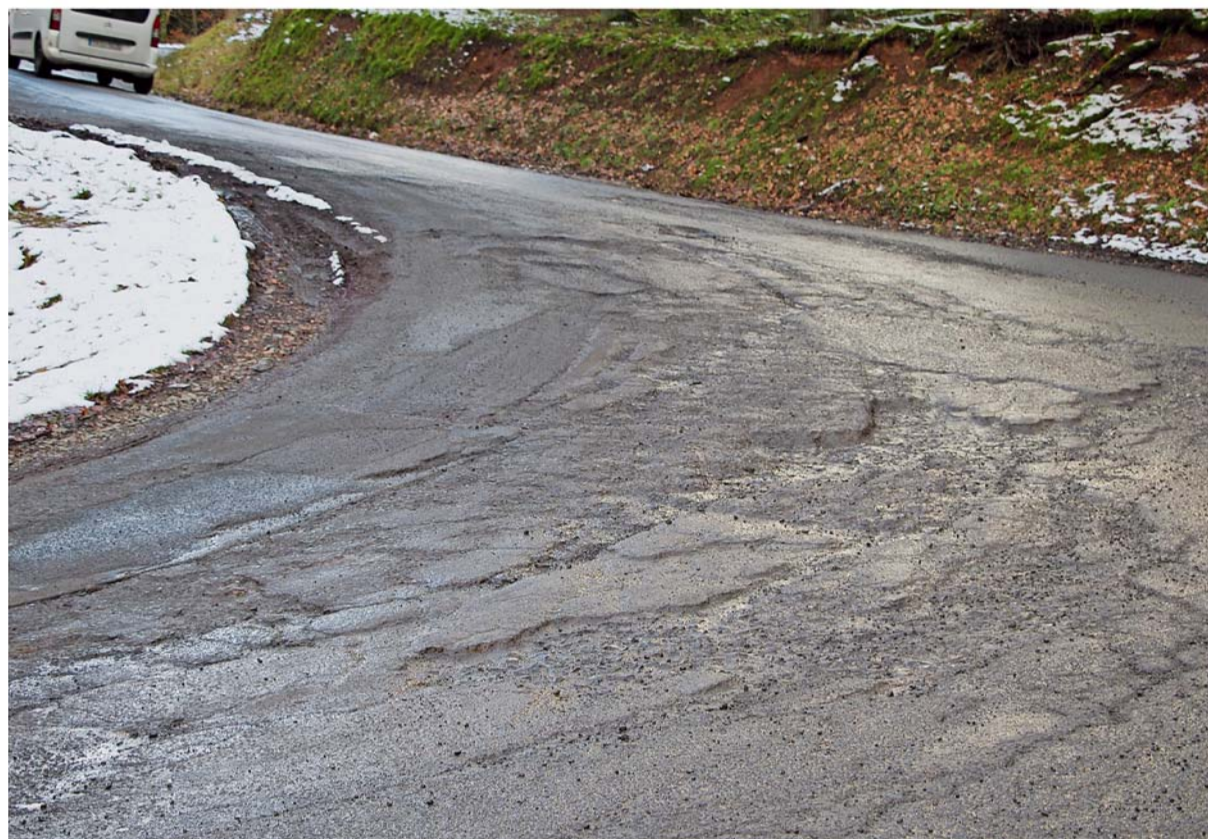
Der Zustand der K 40 ist sehr schlecht. Im vergangenen Jahr musste sie teilweise gesperrt werden.
